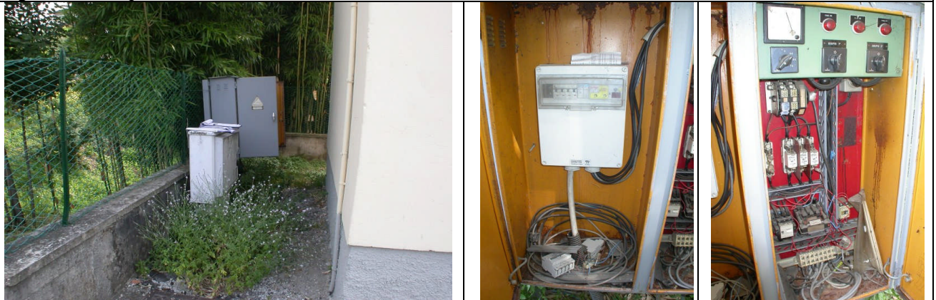
Figura 1.53 – Quadro elettrico n. 4 – Via Ronzone
