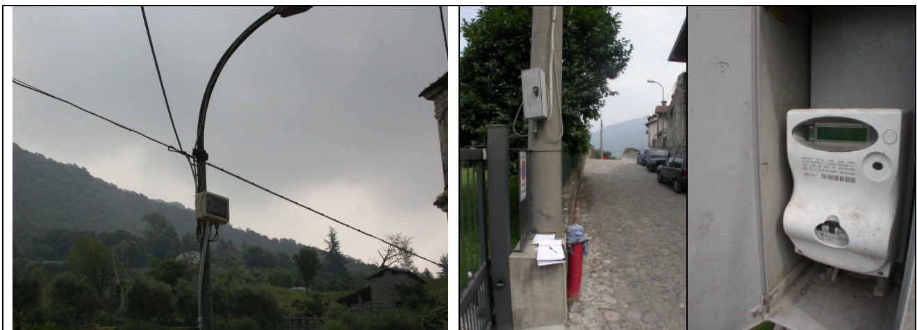
Figura 1.50 – Quadro elettrico n. 1 - Maspiano
