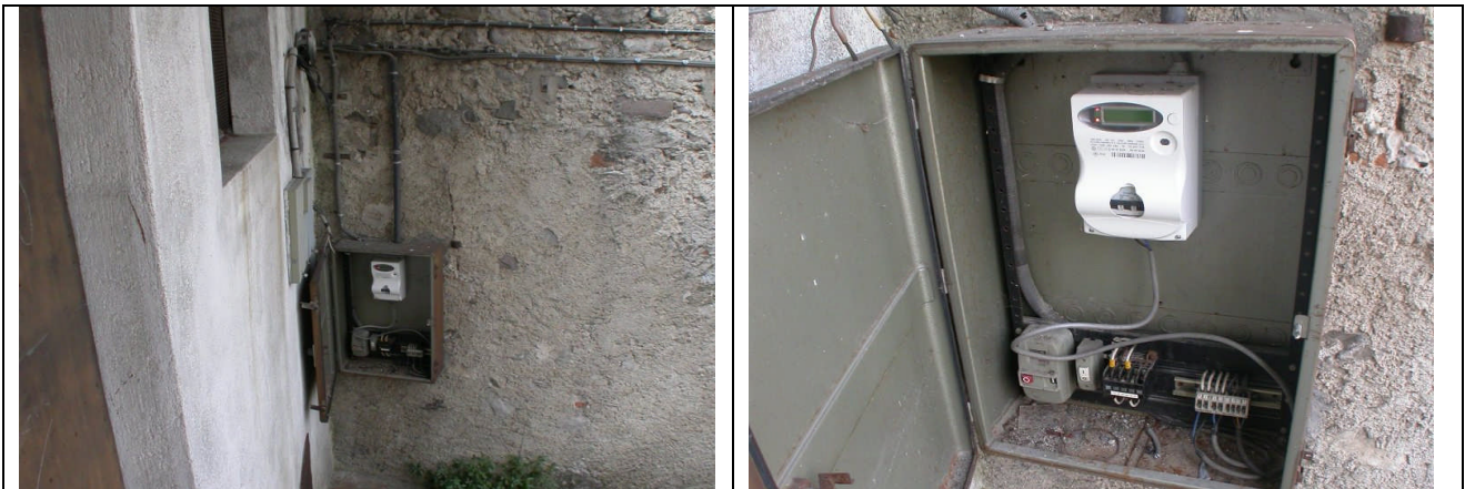
Figura 1.52 – Quadro elettrico n. 3 – Via Riva
