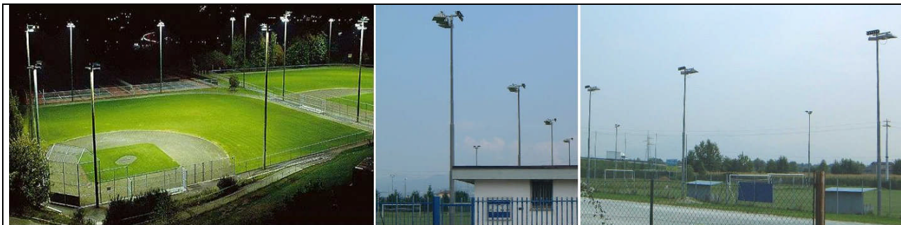
Figura 2.13 - Impianti sportivi illuminati in modo conforme alla L.R.17/00 con proiettori asimmetrici orientati orizzontalmente e che non disperdono luce verso l'alto.
